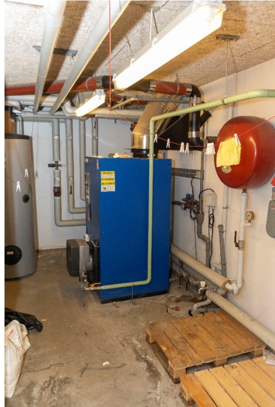
Teknik rum i kælderen
